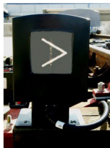
Deviatoio disposto per la deviazione a destra
