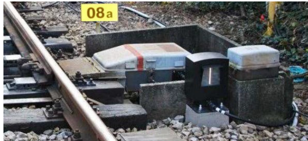
Deviatoio disposto per il corretto tracciato
